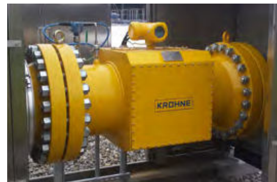
Medida de caudal bidireccional para transferencia de custodia de gas natural en una estación de medida fronteriza
