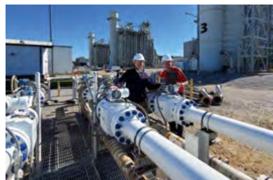
Medida de caudal para transferencia de custodia de gas natural en una instalación de combustible
