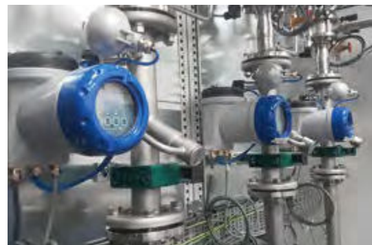
Medida de caudal de gas natural y oxígeno para control de combustión
