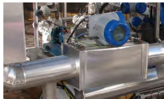
Medida de caudal y concentración para diluciones de ácido sulfúrico
