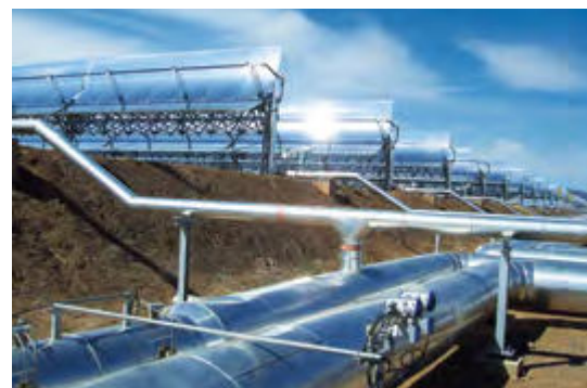
Medida de caudal de aceite térmico en una planta de energía solar de concentración
