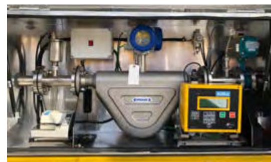
Medida de caudal para la transferencia de custodia de AdBlue® en camiones cisterna
