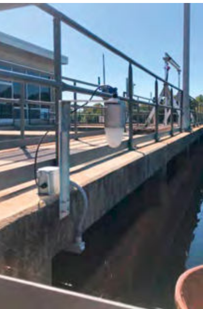
Medida del nivel de depósitos de agua con radar
