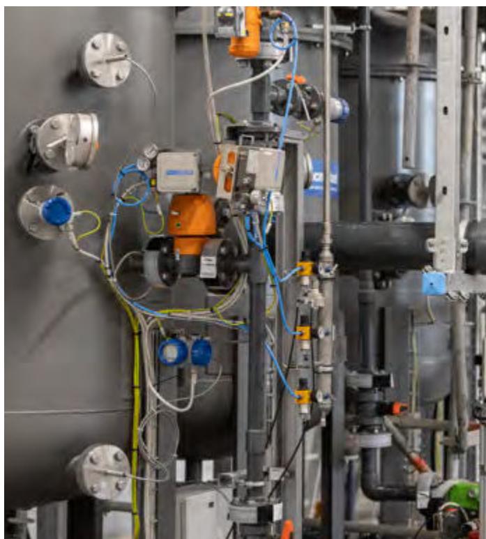
Medida de nivel en depósitos a presión
