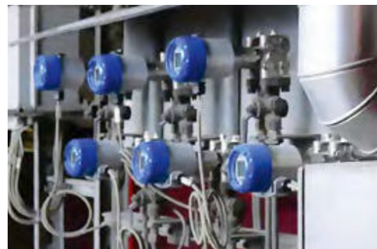
Transmisores de presión diferencial OPTIBAR DP 7060 en una planta de energía
