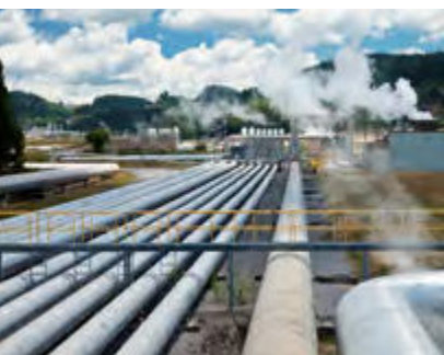
Sistema de medida de vapor geotérmico
