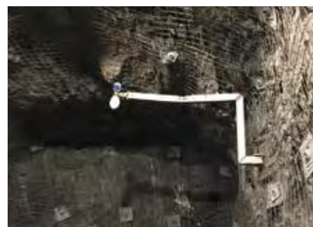
Monitorización del nivel de mineral en una chimenea
