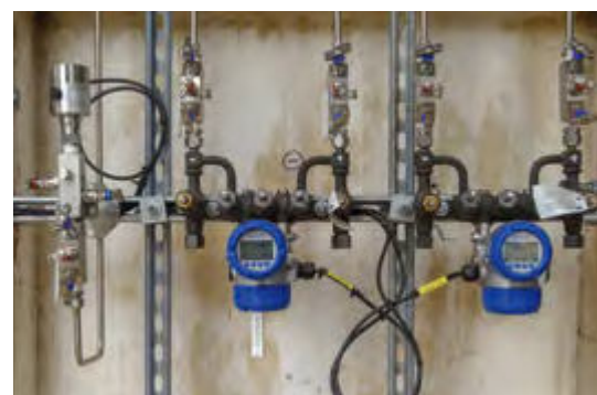
Transmisor de presión en una planta de biomasa
